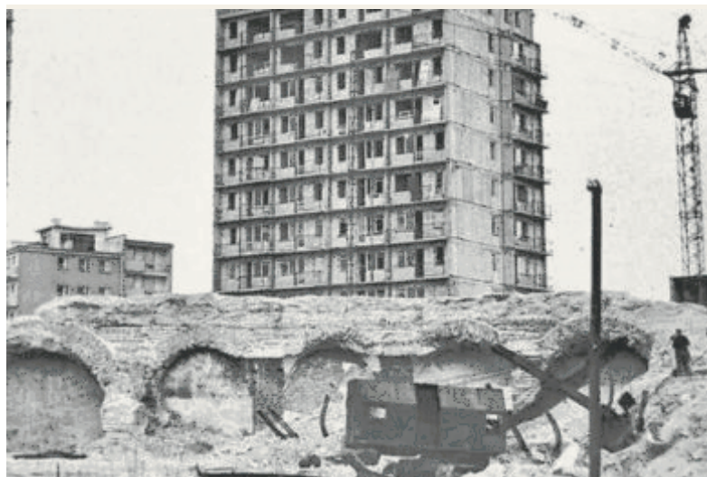
Rok 1967 Budowa wieżowców przy ul. Aleja 700-lecia. Na pierwszym planie rozbiórka lodowni powstałej z fortyfikacji
